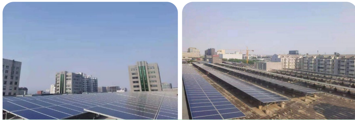
國控山西的屋頂光伏發電設備
