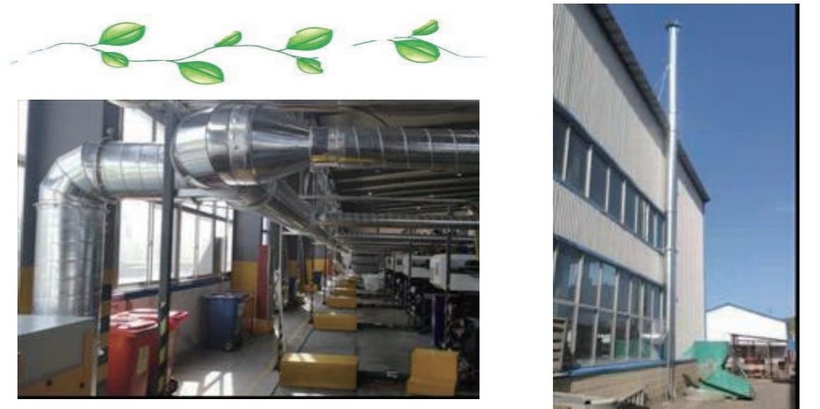
烟台日用友捷汽车电气有限公司塑废气环保治理项目
