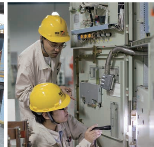
一线工作人员开展电气巡检
