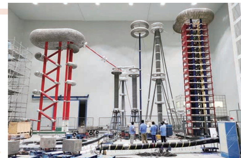
申能集团旗下上海电缆研究所检测平台高压试验大厅
