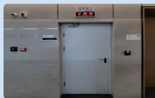
数据中心门禁控制系统
