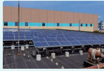
光伏发电系统
