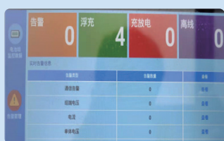
数据中心电池性能检测系统
