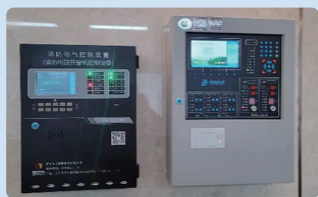
数据中心消防系统
