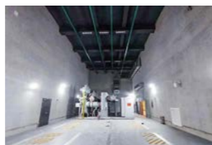
公司设计的国内首座下沉庭院式变电站——雄安新区 110 千伏河西站成功投运
