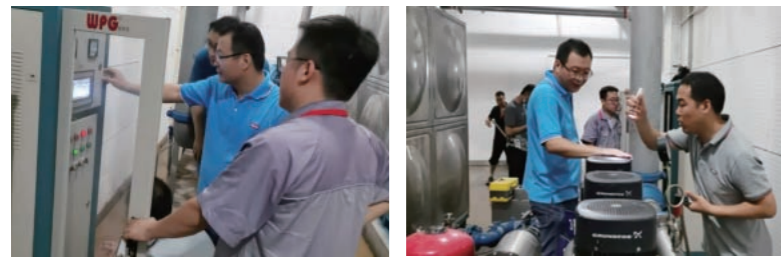
河南郑州，项目上出现紧急维修需求，售后伙伴闪电行动，明确分工，默契配合，顺利完成了维修工作，得到了客户的高度认可。
