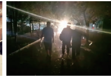
河南郑州市，居民区的供水出现问题发生中断。为了不影响大部分居民用水，凌晨1点30分左右，在水势有所缓和的情况下，威派格售后伙伴冒着雨、踩着水连夜抵达现场，进行抢修，保证在最短时间内恢复供水正常。
