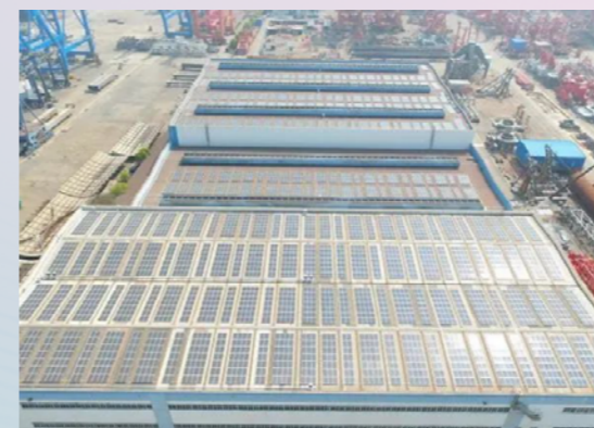
长兴21兆瓦光伏项目。
