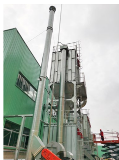
▲ 环保设备将 VOC 气体收集吸附处理后，进行 15 米高空排放。
