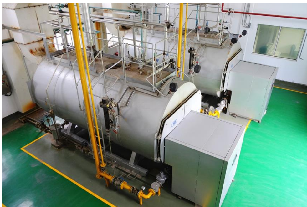
改造前 2 台 4T 燃气蒸汽锅炉
