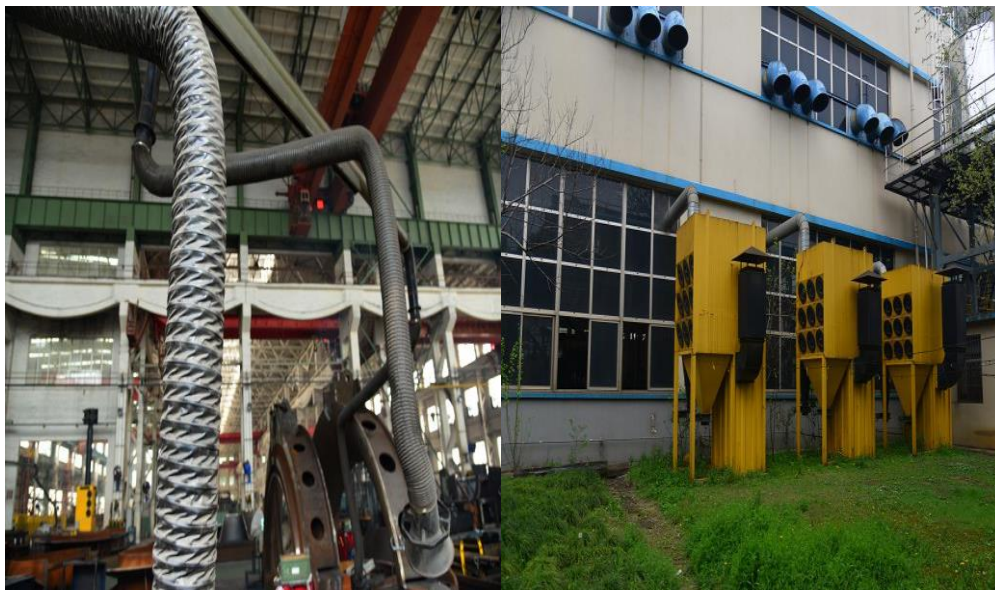
新增的焊接废气除尘装置
