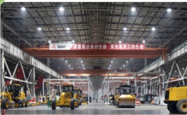
三一重工长沙工厂照明改造后
