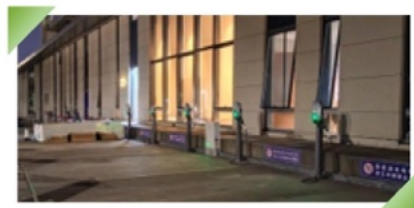
新能源充电桩
