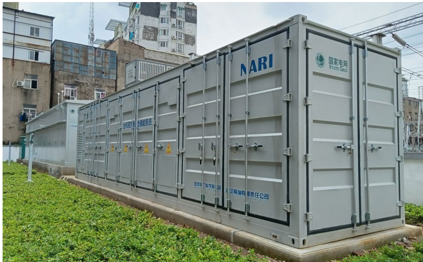
100kW_200kWh 全钒液流电池储能系统应用于汉口火车站充电塔综合能源项目
