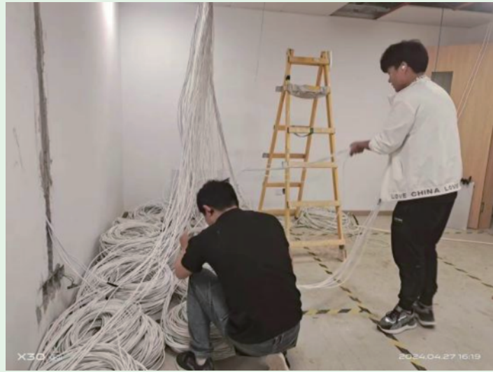
2024年1月，长海医院现场，工作人员了解布线情况
