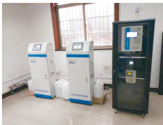
工业废水自动监控设施
