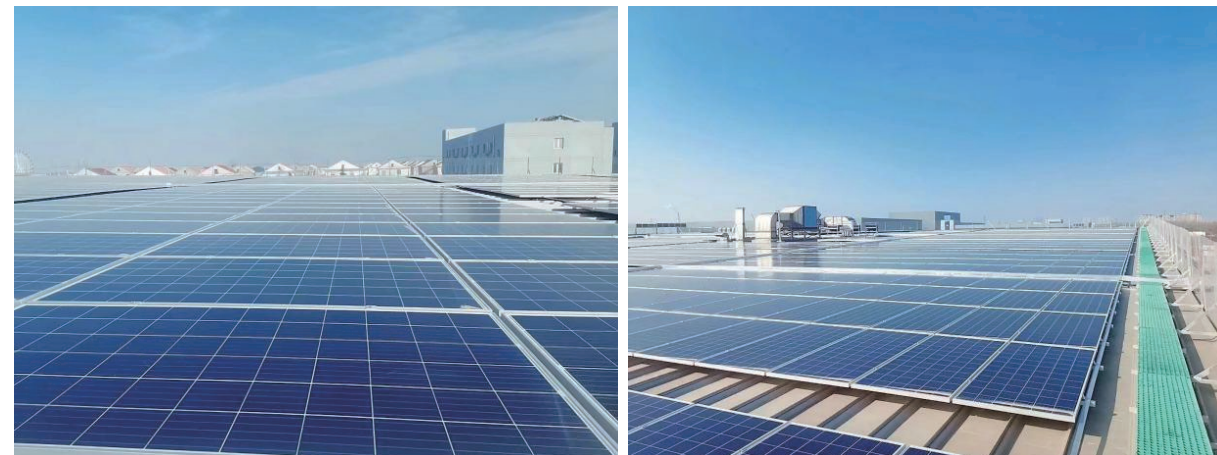
▲ 屋顶分布式光伏发电（连云港新能源工厂）
