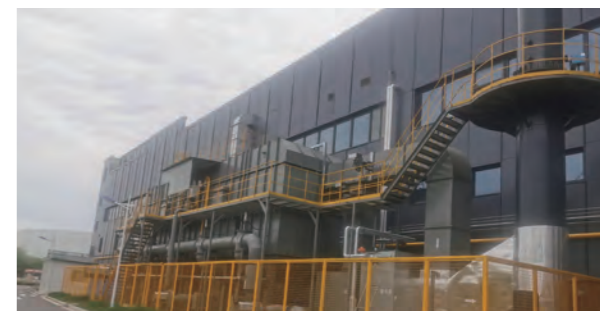
紫江新材料建设RTO塔等环保设施，保证生产过程产生的废气经过充分处理后达标排放。
