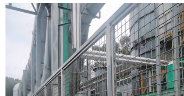
上海紫江彩印对废气处理设施进行改造。2023年，RTO环保治理装置的每万元产值能耗为0.0108吨标煤，同比降低54.81%。
