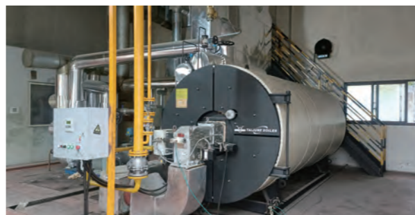
紫东尼龙通过启动锅炉油改气工程，锅炉排放废气实现100%达标，每年增效约135万元。
