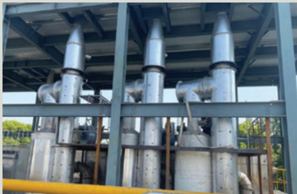
尾氣淨化系統現場
