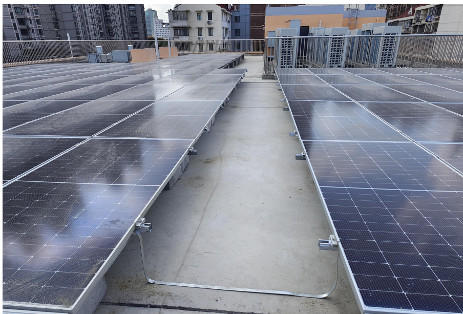
图11：复兴东路小学屋顶光伏发电项目
