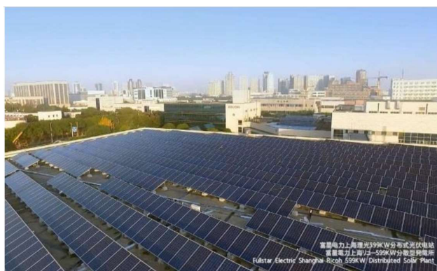
上海理光光伏发电项目
