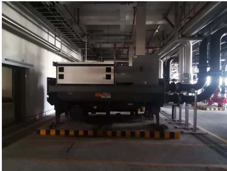
图 10 综合能源站现场照片
