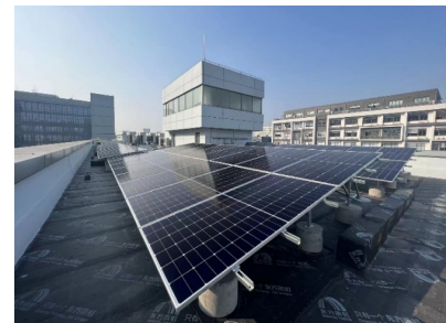
2023年，上海核工院因地制宜，利用本部园区屋顶，成功建设分布式光伏发电项目
