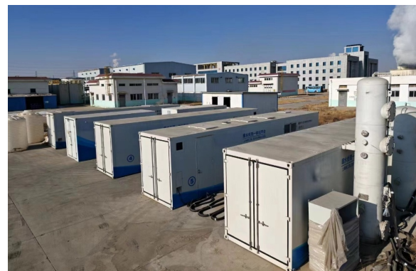
2023年，电子束辐照处理废水中试平台各子系统的单体和联合调试试验顺利完成
