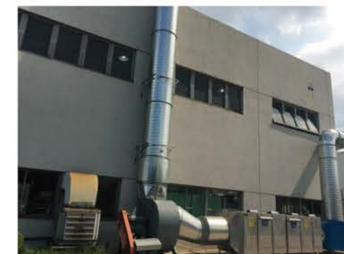
隔音房安装前，风机运行噪声大
