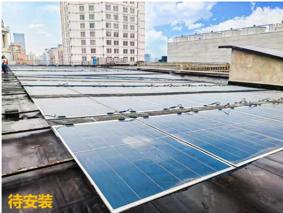
屋顶光伏系统
