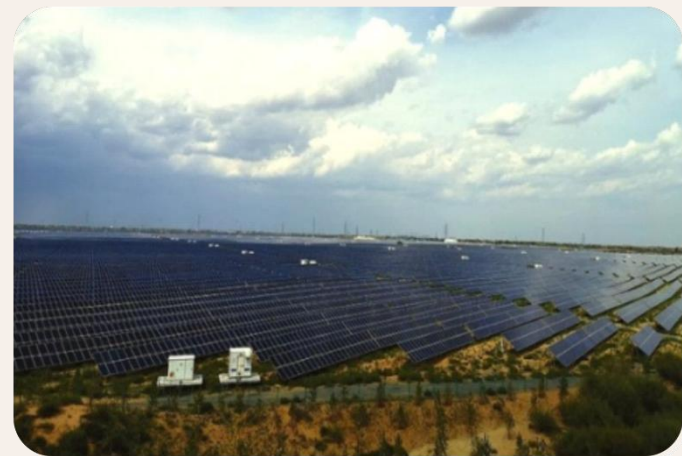
陕西榆林小壕兔200kw光伏发电工程 服务类型：全过程工程造价咨询
