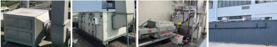
废水、废气治理设施图片
