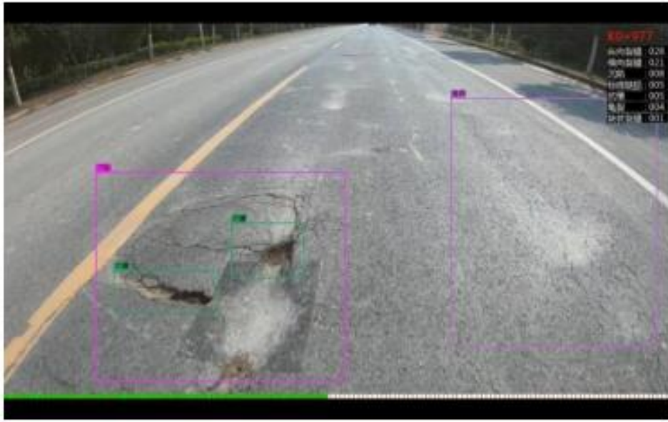
病害影像实景
