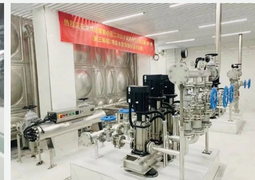
威派格智慧水务设施展示
