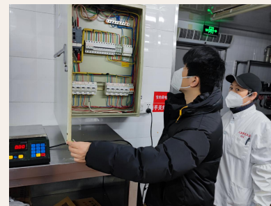
配电箱巡查记录
