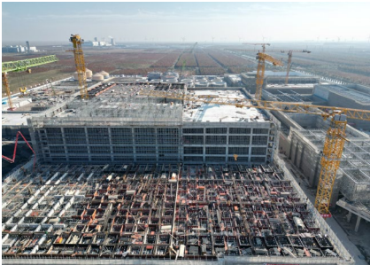
上海生物能源再利用项目三期
