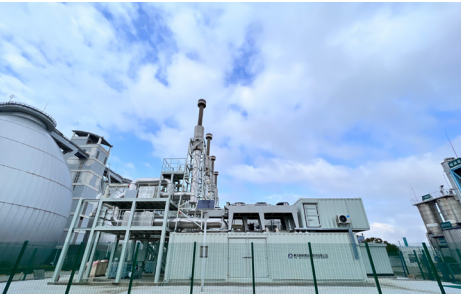
白龙港污泥厌氧消化沼气热电联产项目
