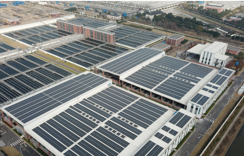
竹园第二污水处理厂分布式光伏发电示范项目
