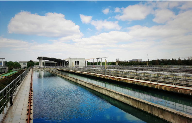
徐泾水厂全力保障进博会供水安全稳定
