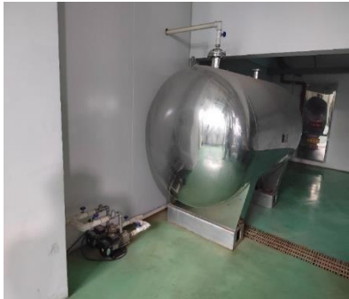
空压机余热回收循环水箱
