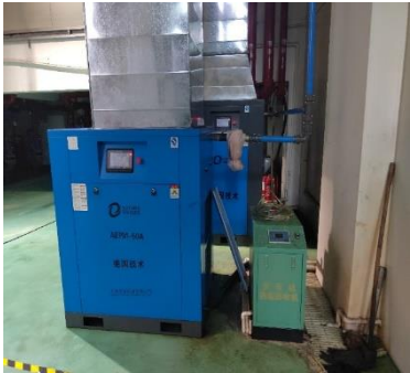
空压机余热回收热交换系统
