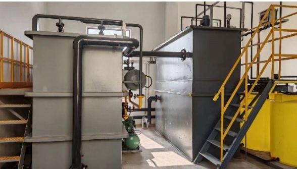
新增废水处理站
