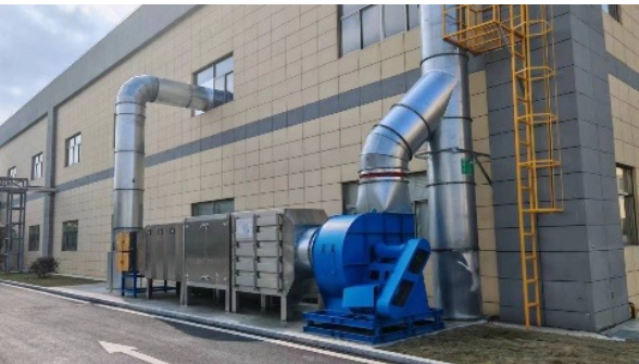
新增废气处理设备
