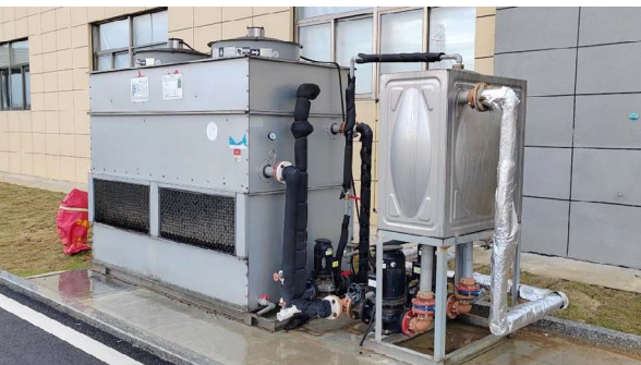
新增闭式冷却塔
